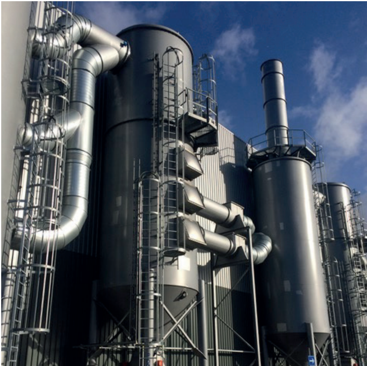
Scheidingsinstallatie AEB Amsterdam
